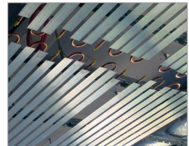
Koperen elementen toegepast boven gipsplafond
