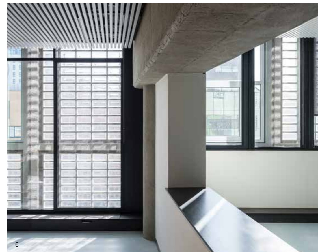
6 Een glazen tweede huid achter de glazen bouwstenen zorgt voor thermische en akoestische isolatie.
